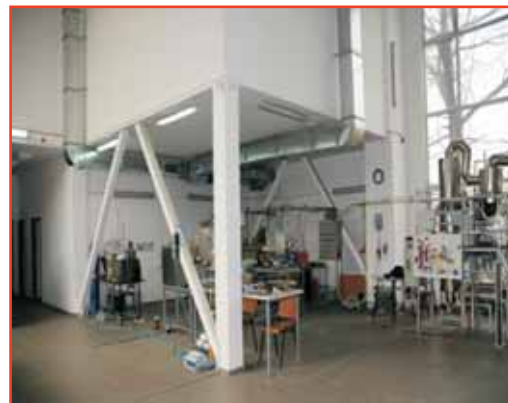
Laborator valorificarea biomasei și deșeurii - instalații pilot de gazeificare și pat fluidizat circulant
