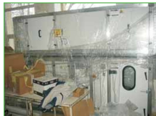
Centrala de tratare a aerului cu filtre HEPA, ce deservește laboratorul de biosecuritate nivel IIII, amenajat la Catedra de Virusologie - Institutul de Virusologie St. S. Nicolau
