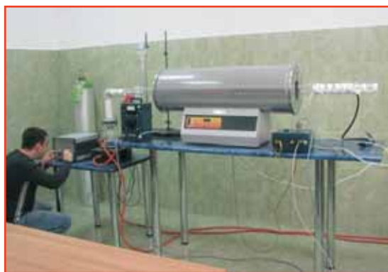
Instalație de prepararea nanopulberilor ceramice prin piroliză
