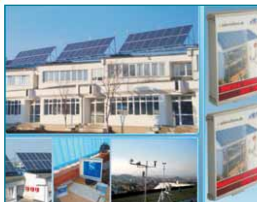
Platformă fotovoltaică de 10kWp, conectată la rețea, cu sistem de achiziție și monitorizare a datelor
